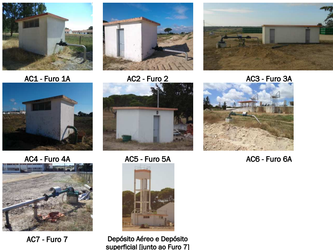
Figura 15 - Registo fotográfico das 7 captações subterrâneas existente no estabelecimento industrial e do depósito aéreo e do superficial de armazenagem de água
